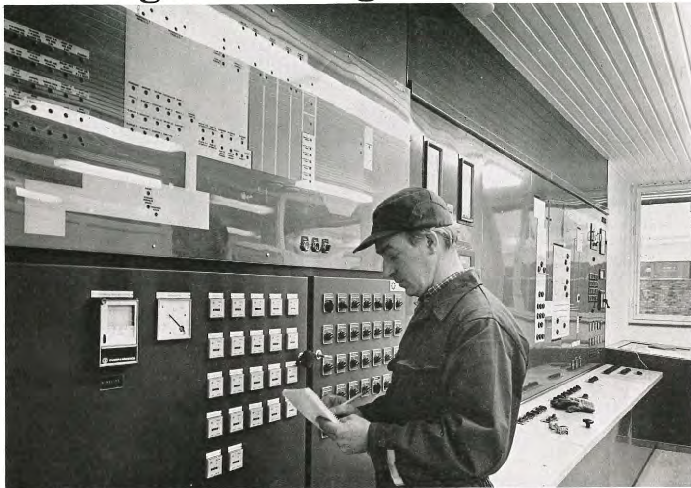
Driften i reningsverket är i stor utsträckning automatiserad. Maskinist Kjell Roxbäck kontrollerar värdena vid slambehandlingen.
