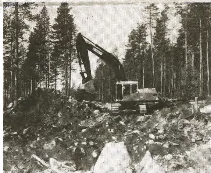
Alla har säkert sett att det i sommar har planerats och schaktats på Nomadskoleområdet. Här ska 35 villor byggas.
