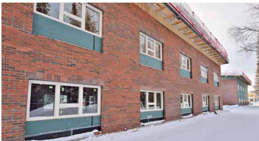
Forsgläntans fasad mot norr. Utvändigt kvarstår täckning av takfot och arbeten runt fönster. Invändigt börjar lägenheterna ta form på plan två.
