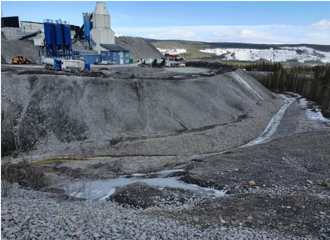
Figur 4.9. Betongstationen på Naloområdet söder om sandmagasinet. Östra skärmdiket är i detta foto synligt vid släntfot.
