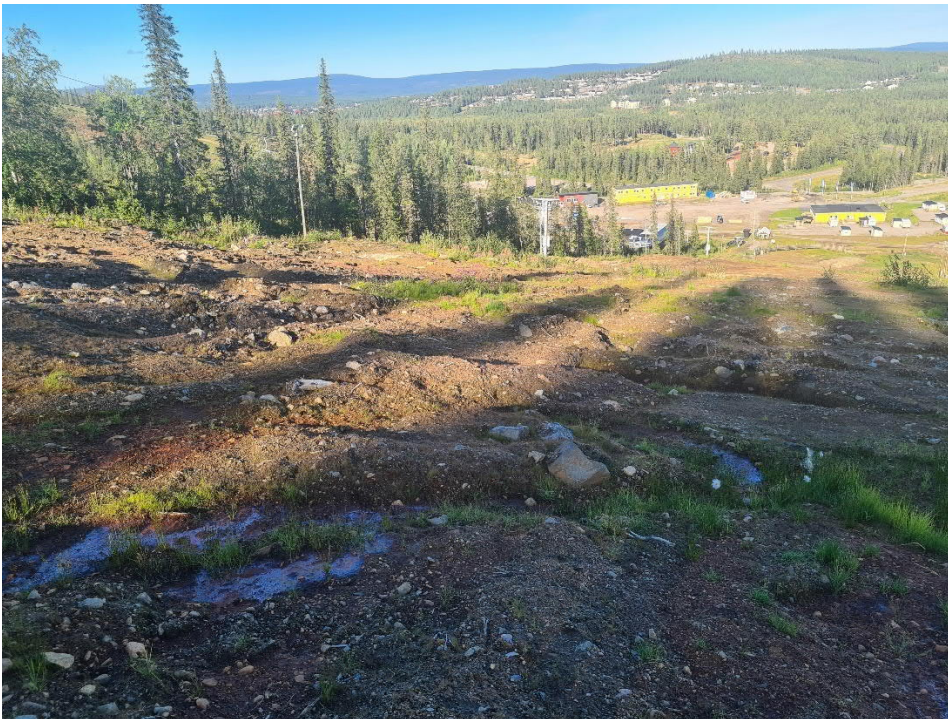
Figur 5 Hjulspår i skidbacke som skapar erosionskanaler för vatten
